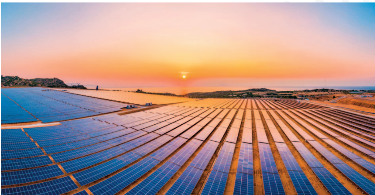
50 MW, Ha Do Ninh Phuoc, Ninh Thuan, Vietnam.
